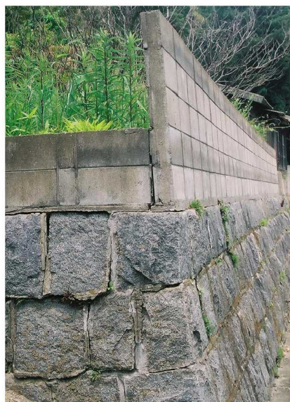
石造の擁壁の直上に基礎なしで設けられた塀。地震により上部が傾き危険な状態である
