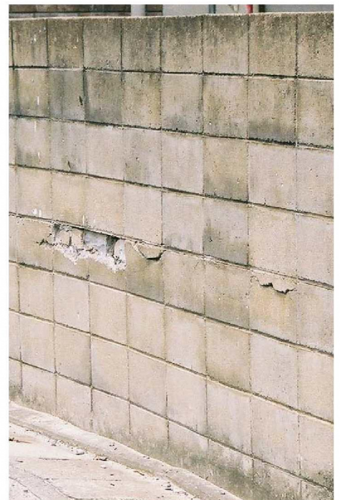
横筋が腐食・体積膨張し、ブロックを損傷している危険な塀
