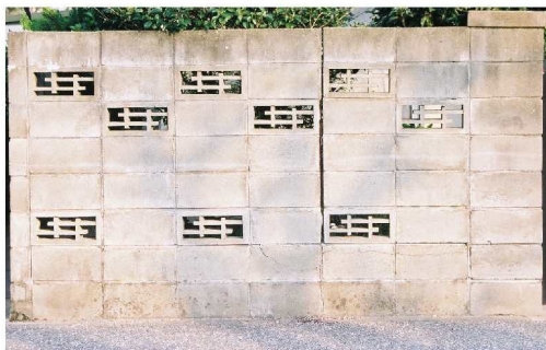
たて筋・よこ筋が施工されないと、継ぎ目がひび割れるなど危険な状態となる
