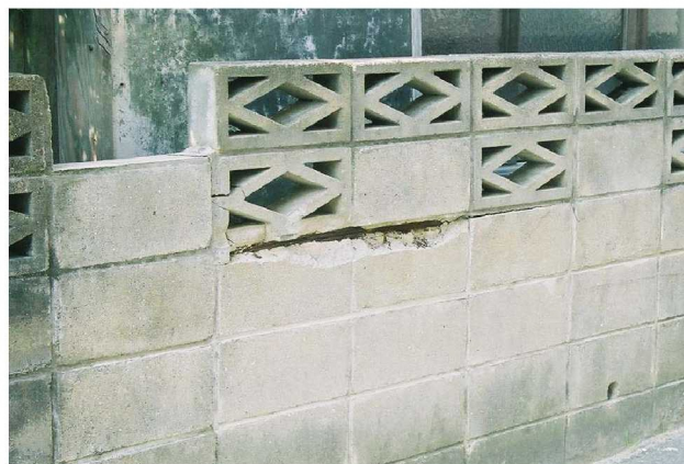
透かしブロックの直下の横筋が腐食し、地震で損傷した事例
