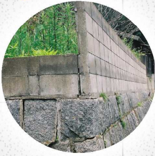
擁壁上のブロック塀 の危険性
