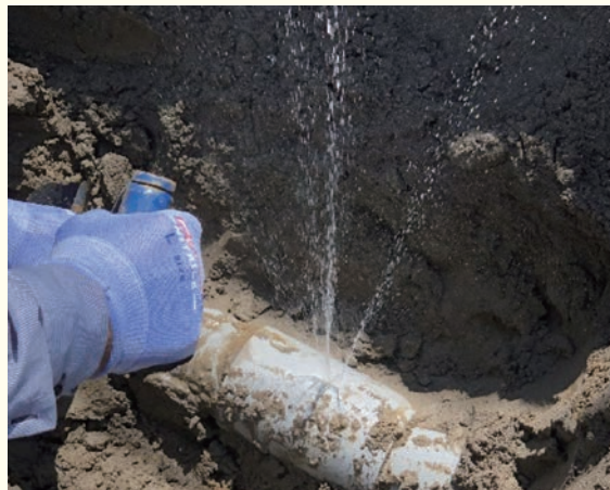
漏水している水道管
